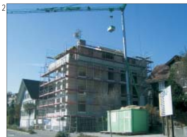
1 MFH Kleinmatt, Merlischachen Bauherrschaft: P. u. R. Räber-Tonini Architektur und Bauleitung: Baggenstos & Seeholzer, Merlischachen
